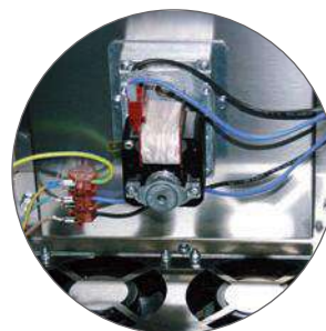
Ventilation des moteurs / Motors ventilation
